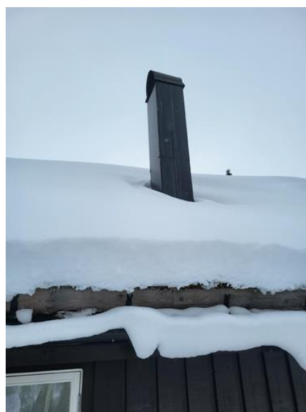
Utvendig - [Pipe overtak]
