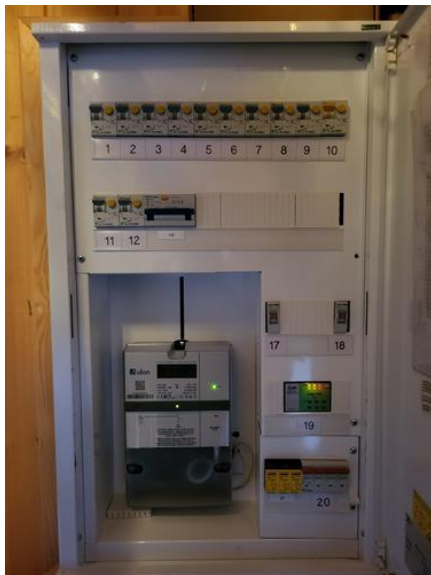
Elektrisk anlegg - [Sikringskap]
