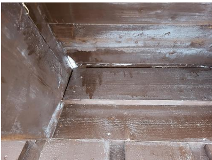
Utvendig - [Tegn på kondens/rim i luftespalte mellom sperrer.]
