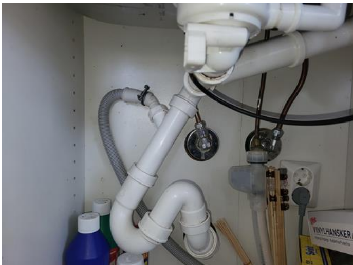
Kjøkken - [Rørapplegg kjøkenbenk]
