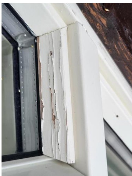
Utvendig - [Slitasje på glasslister.]
